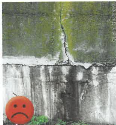
Bild links: Durch Risse im Güllebehälter tritt gut sichtbar Gülle aus.
